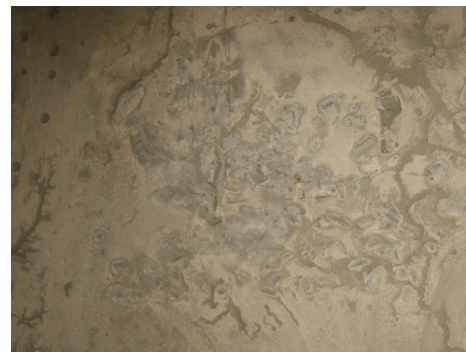
写真-7 グラウト粉砕化箇所の状況
