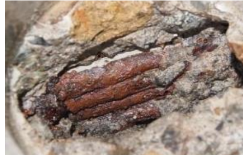
写真-1 既設 PCT 桁橋の主ケーブルに生じた著しい腐食
