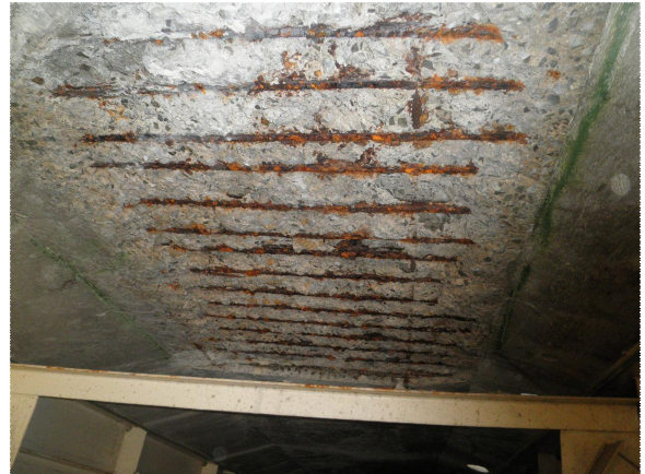
写真-1 床版劣化状況
