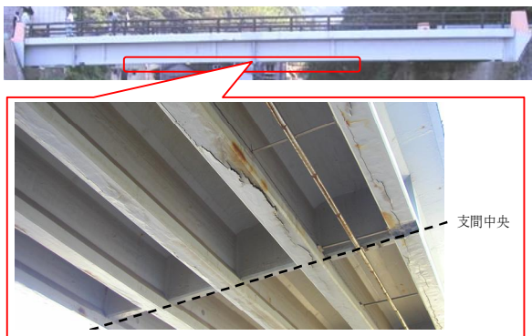
写真-1 厳しい塩害環境で劣化した PC 橋の例
