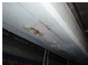
(a) かぶりコンクリートの浮き
