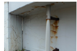
(b) ASR によるひび割れ
