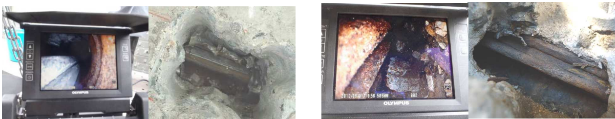
写真-5 グラウト充てん不足部の PC 鋼材の腐食状況 左：終点側 No.2 右：終点側 No.3
