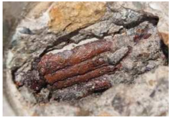
写真-2 PC 鋼材の著しい腐食
