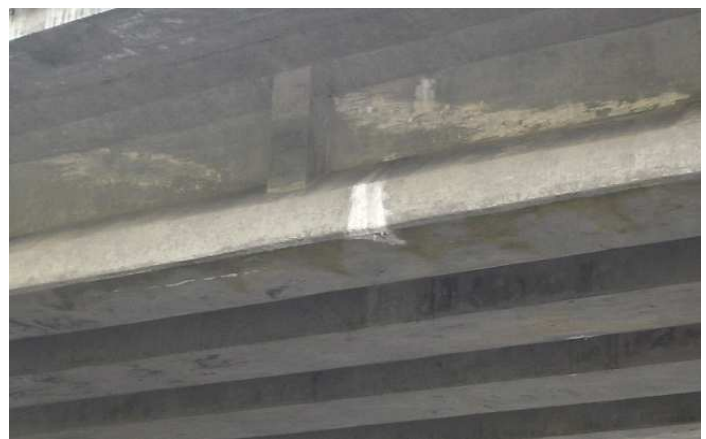
写真-1 既設 PC 橋のウェブ側面に生じた変状例 (主ケーブルに沿ったひび割れと漏水)
