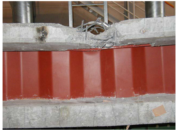
写真-6 破壊状況(支間中央)
