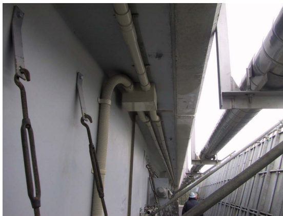
写真-17 径間部配管状況
