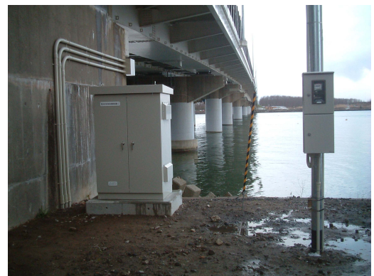
写真-19 直流電源装置
