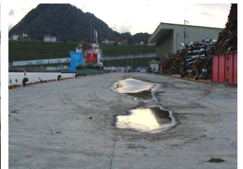
写真-7 岸壁背面の沈下帯
