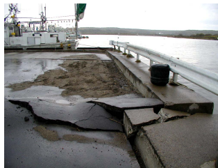
写真-6 岸壁背後の被害
