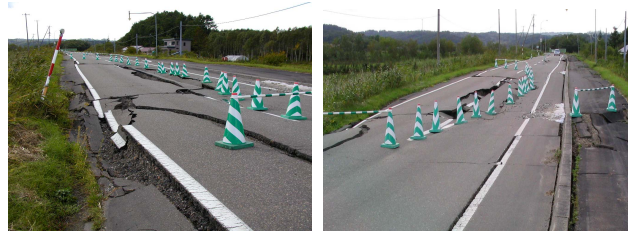
写真-5 豊頃町地内 336号線の道路被害例
