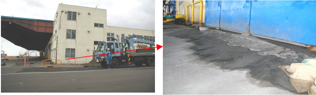
釧路東港・釧路漁業埠頭第7魚揚場の建物の不同沈下と噴砂痕 写真-27 港湾施設の被害状況
