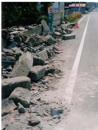
写真-11 倒壊した野蒜石積塀
