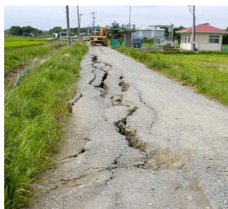
写真-3 農道の被害
