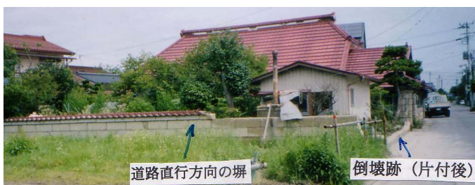
写真-13 倒壊の方向性を暗示する石積塀倒壊例
