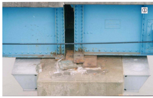
(4) 橋脚部支承部の変状
