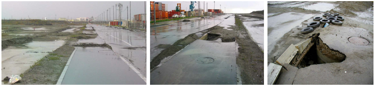
(1) アクセス道路 (2) 路面に生じた噴砂孔 (3) 歩道に生じた噴砂による陥没
