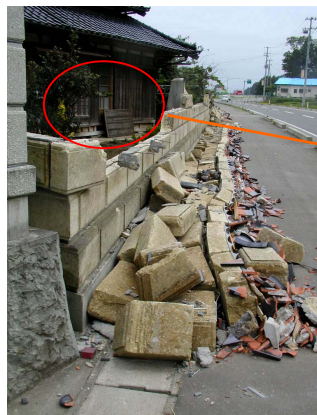
写真-12 倒壊した鉄筋補強石積塀
