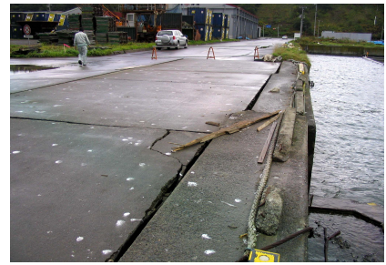
(3) 十勝港第2埠頭岸壁の変形
