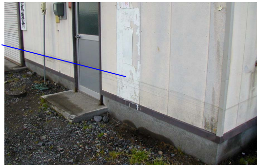
写真-20 広尾漁港の津波浸水痕(青線,高さ約2m)
