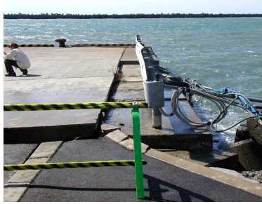
(2) 浦河港スラブの浮き上がり
