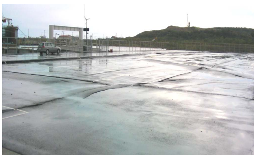
写真-26 大津港舗装面の変状
