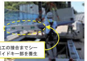
写真-9 接合目地部の汚れ防止
