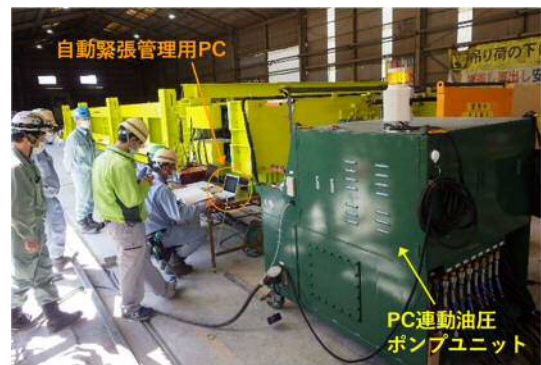
写真-1 自動緊張管理システム
