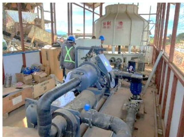
写真-14 現場内プラントに設置した循環水冷却装置
