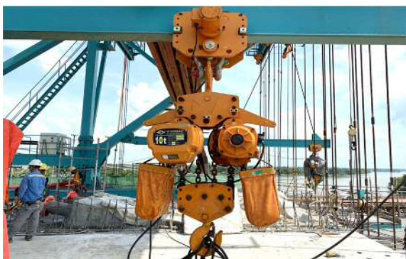
写真-4 電動ホイスト（10t吊り）
