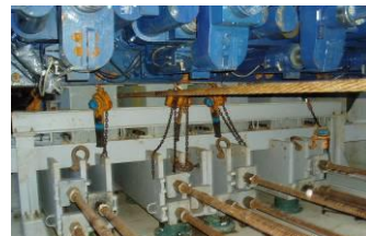
写真-4 橋軸地震時対抗装置
