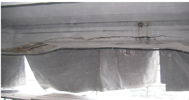
写真-2 RC 栈橋部損傷箇所
