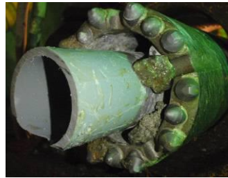
写真-4 閉塞状況
