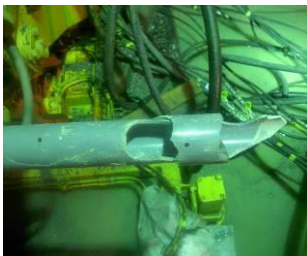
写真-3 保孔管破損状況
