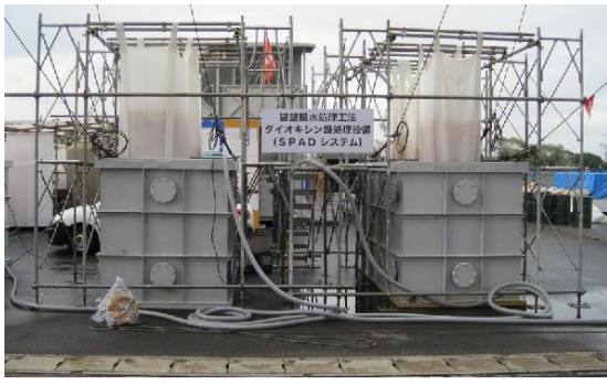
写真-2 処理設備
