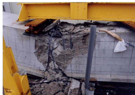
写真 - 2 破壊状況
