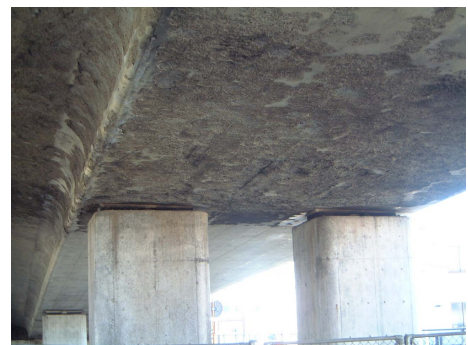
写真-1 損傷状況
