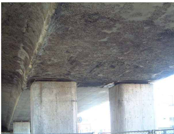
写真 - 3 損傷状況
