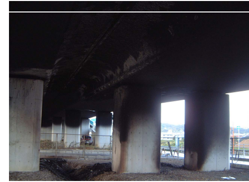
写真 - 1 火害後の状況 (P2付近からP3方向を望む)
