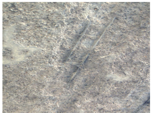
写真 - 4 鉄筋の露出状況
