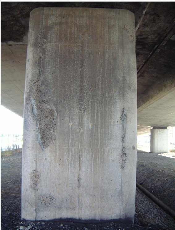
写真 - 4 損傷状況
