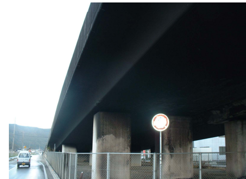
写真 - 2 火害後の状況 (P2付近からP1方向を望む)
