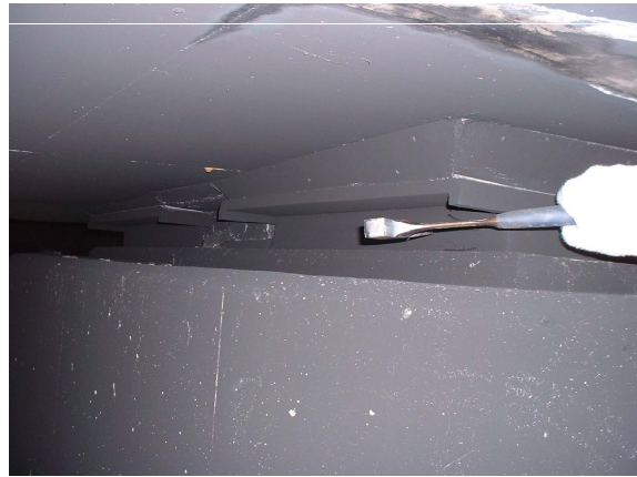
写真-7 損傷状況(P3支承)
