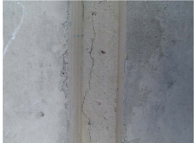
写真-1 誘発目地に発生したクラック
