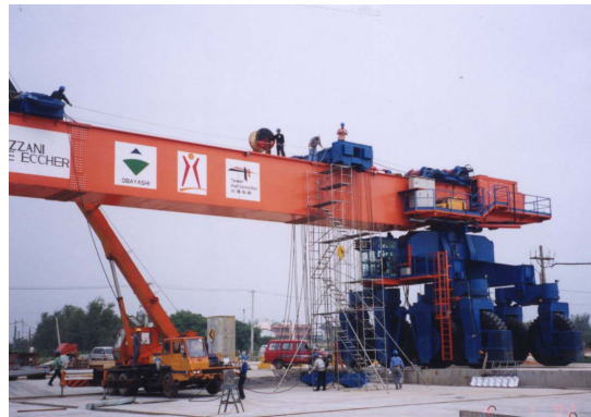
写真 - 5 特殊桁吊り移動車(キャリア)
