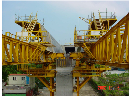
写真 - 11 移動支保工設備
