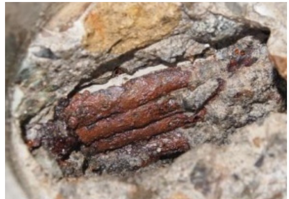
写真-1 既設 PCT 桁橋の主ケーブルに生じた著しい腐食
