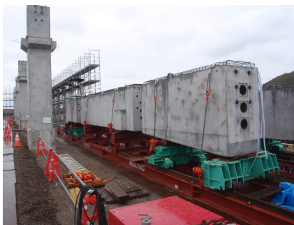
写真-1 軌条設備
