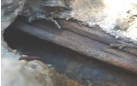
写真-2 PC 鋼材の腐食状況
