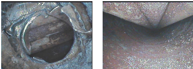
写真-1 グラウト未充填状況
