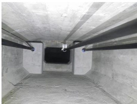
写真-1 箱桁内ケーブル配置
