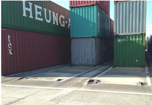
写真-1 アスファルト舗装面の沈下
