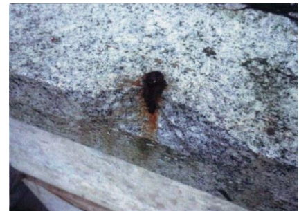
写真-25 剥落した石材 ※アンカーボルトが腐食膨張を起こし石材が剥落
