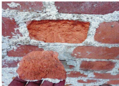
写真-21 煉瓦表面の剥離 ※漆喰が剥離し露出している
