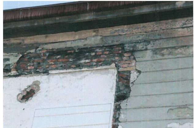
写真-19 漆喰剥落状況
