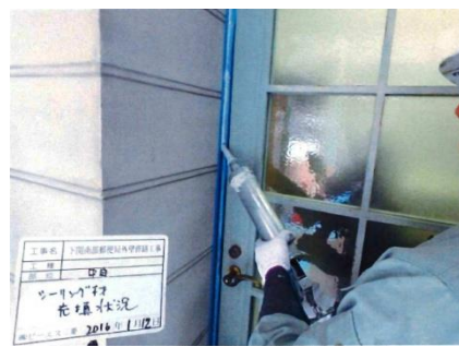
写真-52 建具周りシーリング
