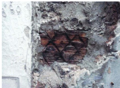
写真-24 壁内に残された木片 ※壁内に残されそのまま埋められた木片が露出
