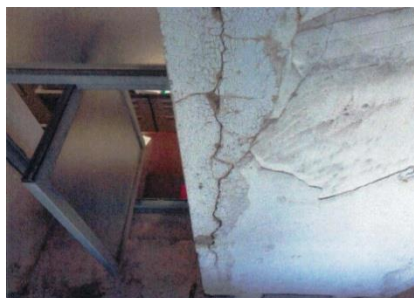
写真-27 窓ダキのひび割れ ※窓ダキに数ヶ所大きなひび割れが発生
