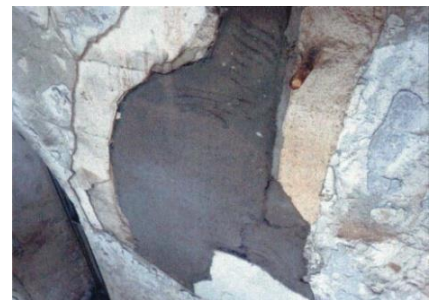
写真-22 剥き出しになった補修部 ※過去の補修により漆喰の仕上無しに塗られた補修モルタル
