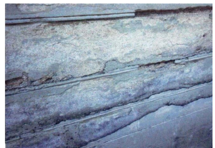
写真-28 漆喰の表面劣化・浮き ※漆喰はすべて浮上っており、軽度の打撃でも剥落する状態
