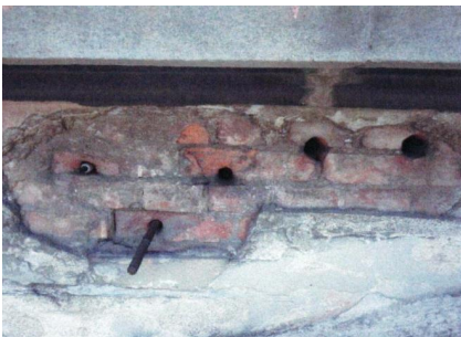
写真-23 パイプ・鉄筋の露出 ※過去に使われた穴や鉄筋がそのまま放置されている
