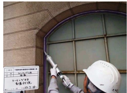
写真-37 建具周りシーリング
