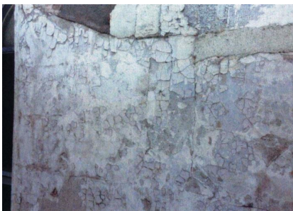
写真-26 亀甲状のひび割れ ※過去数度にわたり施された補修部表面の塗装剤が肌分れ
