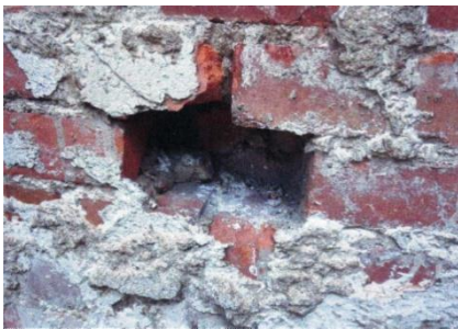
写真-20 煉瓦欠落部分 ※煉瓦が欠落し穴があいている
