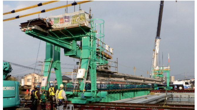
写真-2 ノーズ式横取り装置 (起点側)
