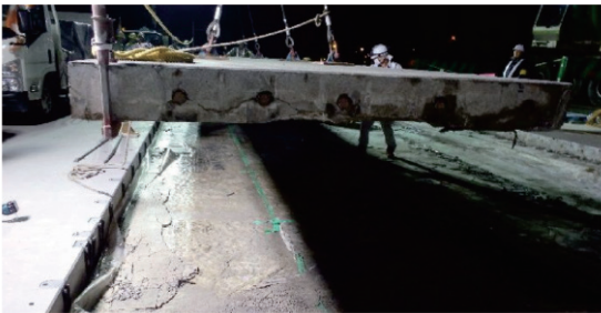
写真-1 PCa 舗装版の損傷と裏込めグラウトの粉状化
