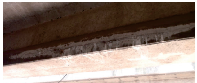
写真-2 対象主桁下フランジの変状
