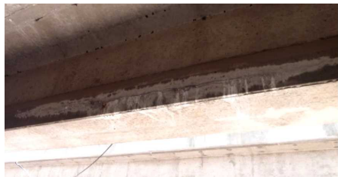
写真-2 対象主桁下フランジの変状
