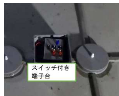
写真-8 モニタリングボックス設置
