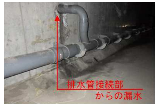
写真-1 漏水状況
