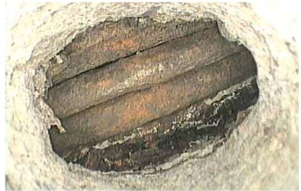
写真-4 PC 鋼材の健全度 3 の状況
