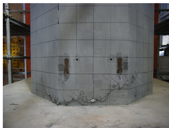
写真-4 破壊状況(基部圧縮縁)
