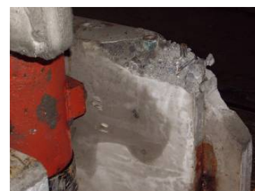
写真－30 杭の角欠け
