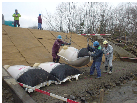
写真-9 設置状況
