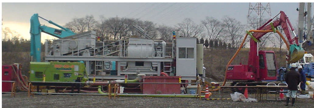
写真-6 SPADシステム全景
