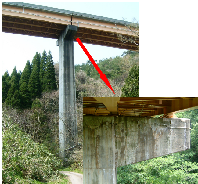
写真-2 補強前橋脚および梁部損傷状況
