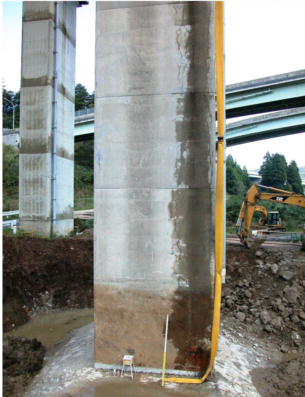
写真-5 脚柱部 A 橋の損傷状況 (側面)
