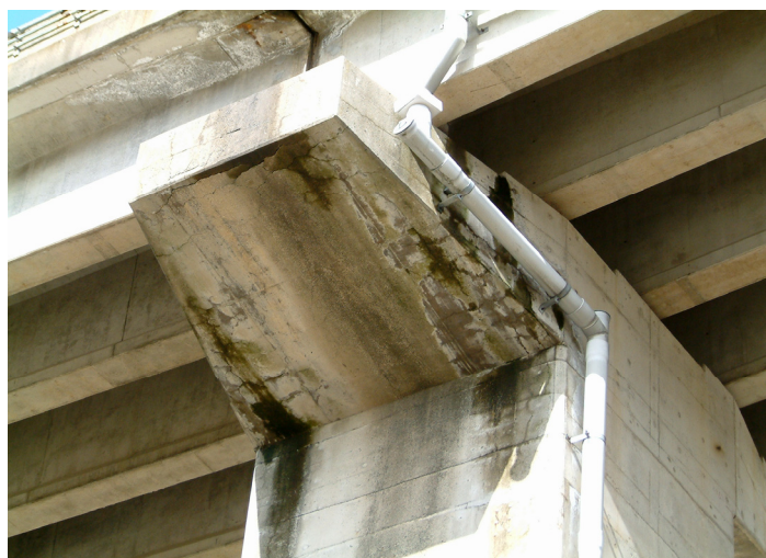
写真-4 A橋梁部の損傷状況
