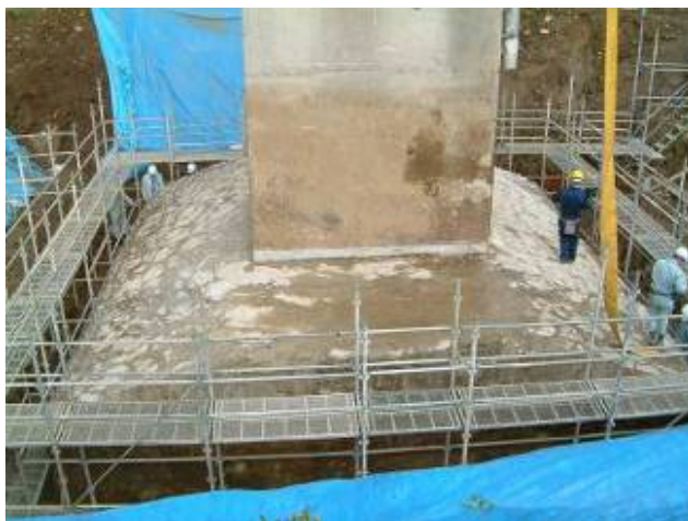
写真-7 A 橋フーチング上面の損傷状況
