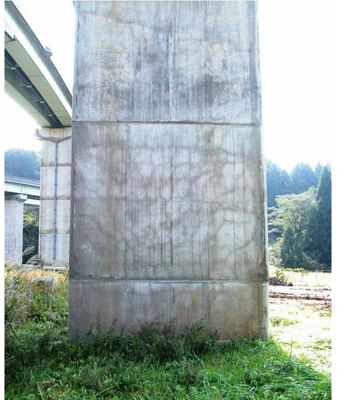
写真-6 脚柱部 A 橋の損傷状況 (正面)
