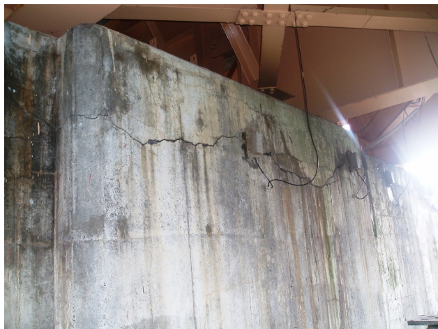
写真-9 B橋梁部の劣化状況（柱頭部）
