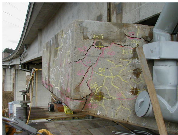
写真-1 橋脚張出し部の劣化損傷状況
