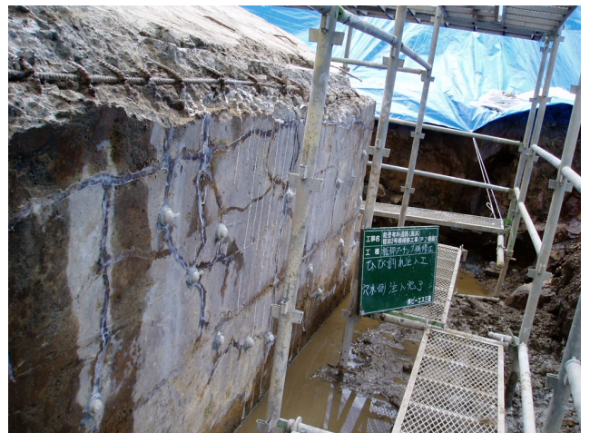
写真-8 A 橋フーチング鉛直面のひび割れ状況
