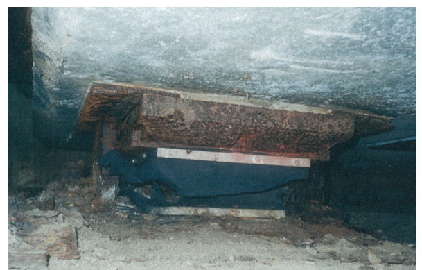
写真-10 A2橋台支承 損傷状況
