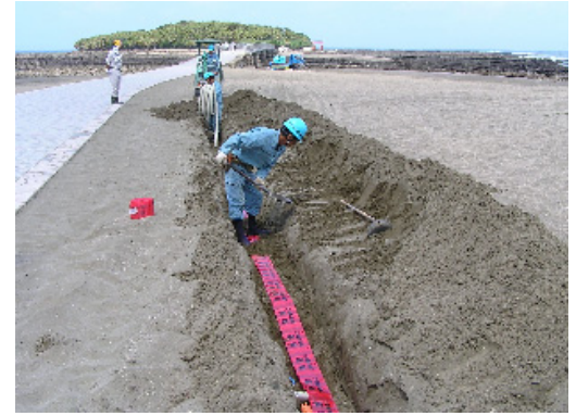
写真—19 配管状況
