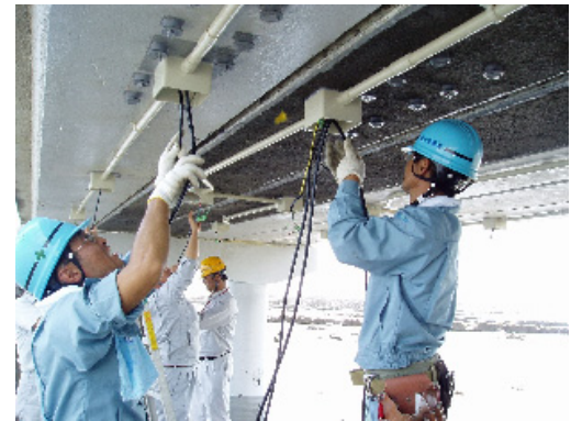
写真—20 配線状況
