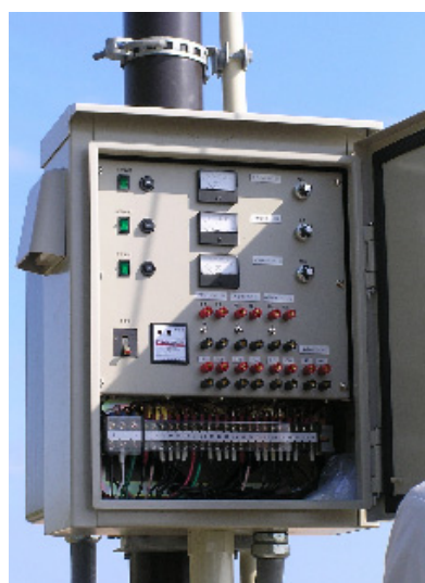
写真—18 直流電源装置
