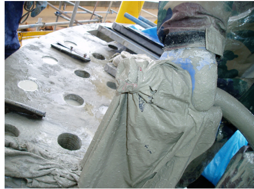
写真-15 ビニール破断状況
