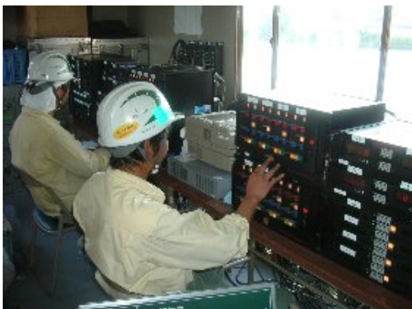
写真-2 集中制御室
