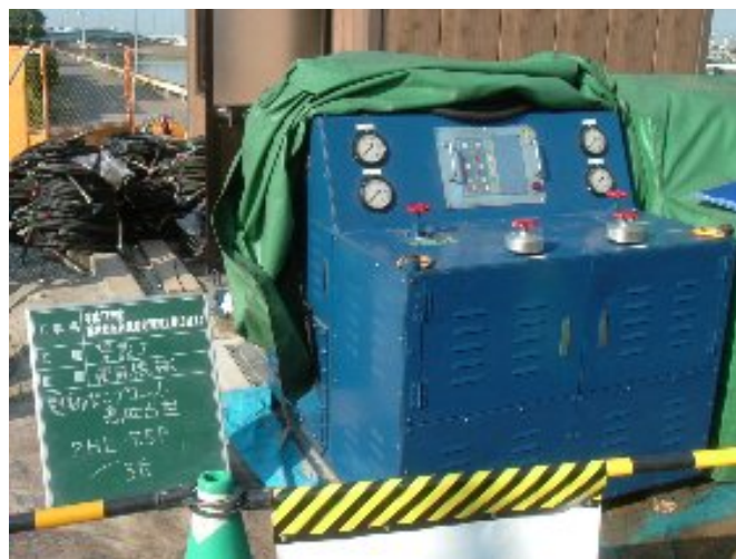
写真-4 ポンプユニット
