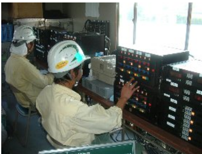
写真-3 集中制御室
