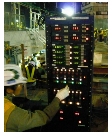
写真-5 ダウン用ジャッキ制御板
