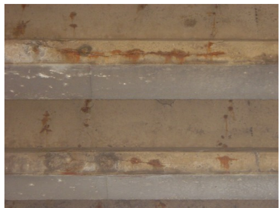
写真-2 主桁劣化部
