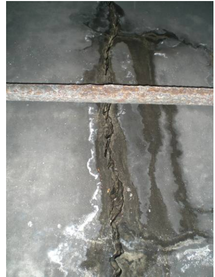
写真-1 I期線覆工変状状況
