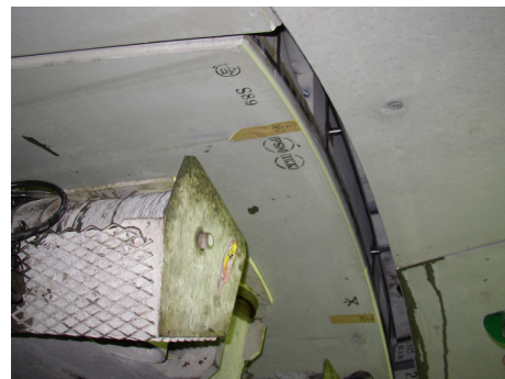
写真-15 Kセグメント組立状況 Kセグメントの組立が終われば1リング完成。
