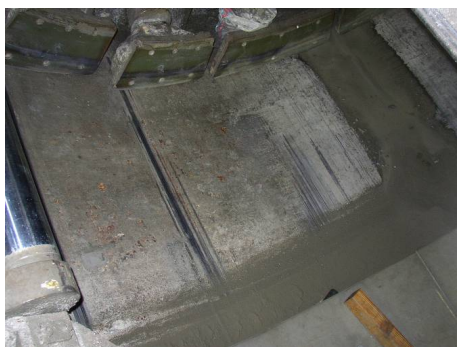
写真-6 掘進ジャッキ戻し 掘進が完了し、最初のセグメントを設置するために、掘進ジャッキを戻した状況。
