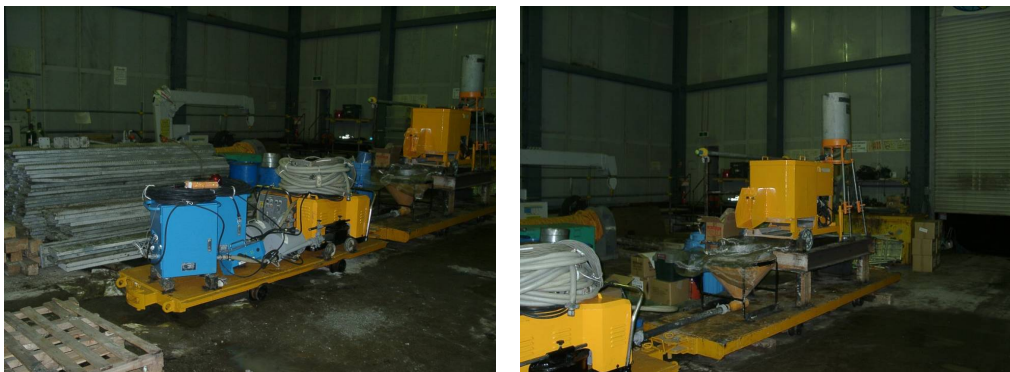
写真-21 グラウトプラント
