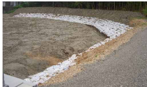
写真-5 90日経過後状況
